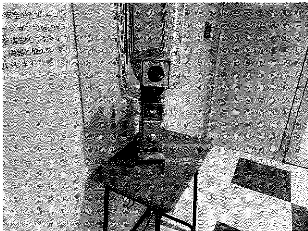
23 防犯カメラ②廊下
