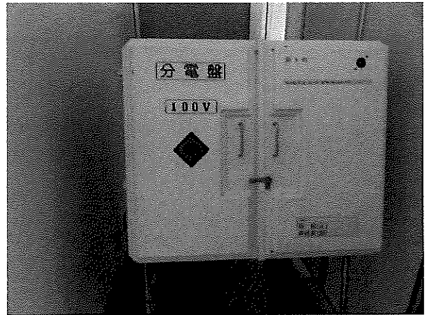
24 療養室分電盤
